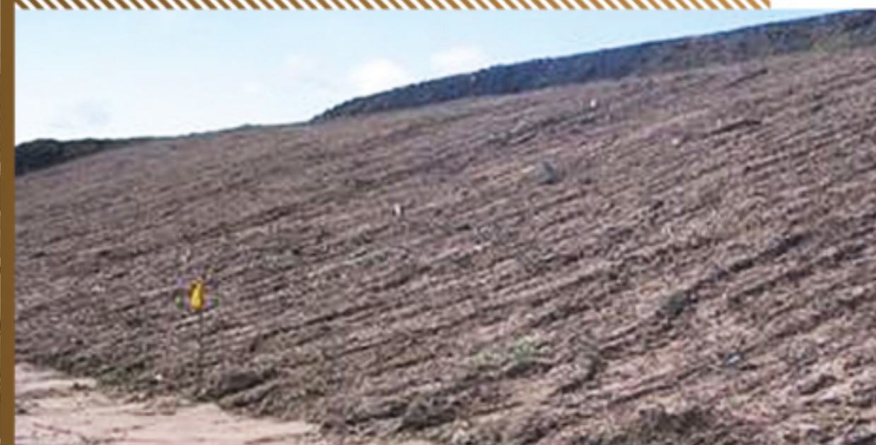
Obra en ejecución, revegetalización Loma del Marión - Distrito de Cartagena. Archivo Cardique
