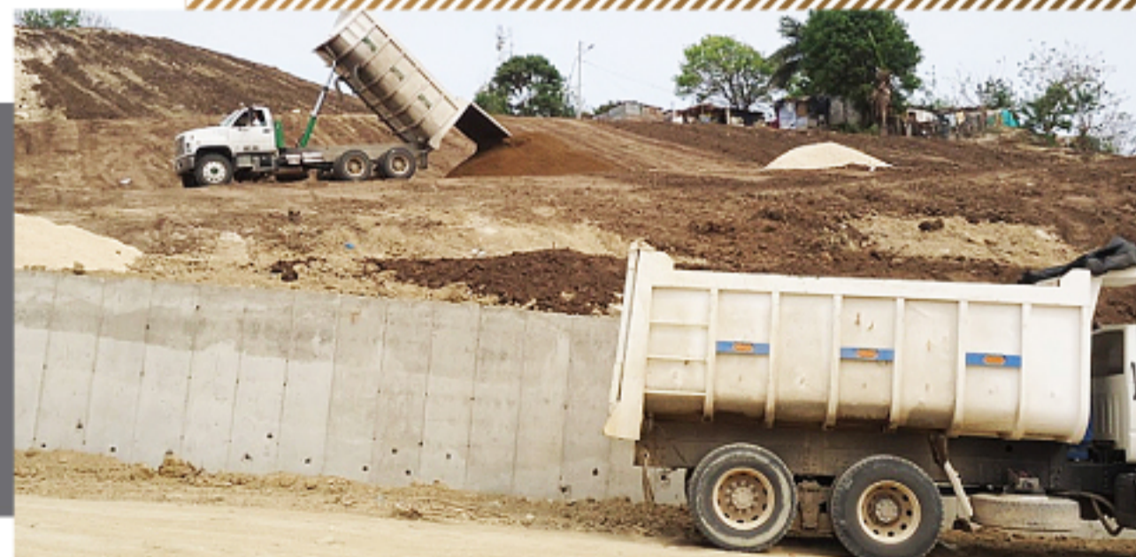
Obra en ejecución, Loma del Marión - Distrito de Cartagena de Indias. Archivo Cardique
