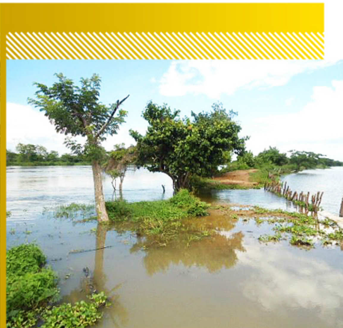
Estado inicial de la obra, chorro Rabón - Municipio de San Cristóbal. Archivo Cardique
