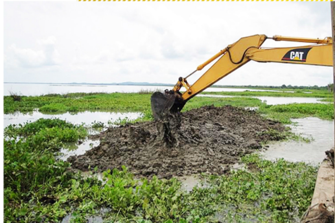
Obra en ejecución, canalización del canal Evitar - Municipio de Mahates Archivo Cardique
