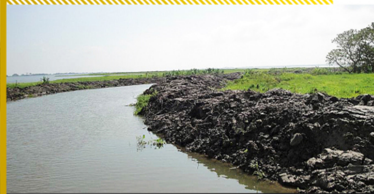
Estado final de la obra, chorro Zarzal - Municipio de Mahates Archivo Cardique
