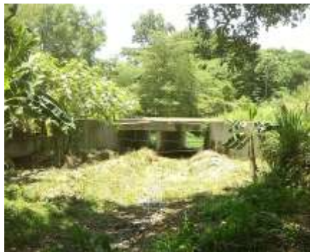
Fotografía No.1 material que está depositado sobre el lecho y próximo al box coulvert y cubriendo el solado
