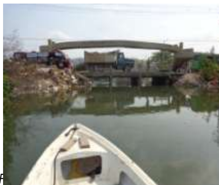
Foto No 3. Lancha pequeña de la Corporación no pudo continuar con el recorrido debido a que el motor de ésta rozaba con la estructura del mismo.
