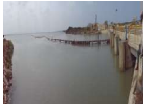
Foto 7. Tabique direccional en avanzado estado de deterioro.
