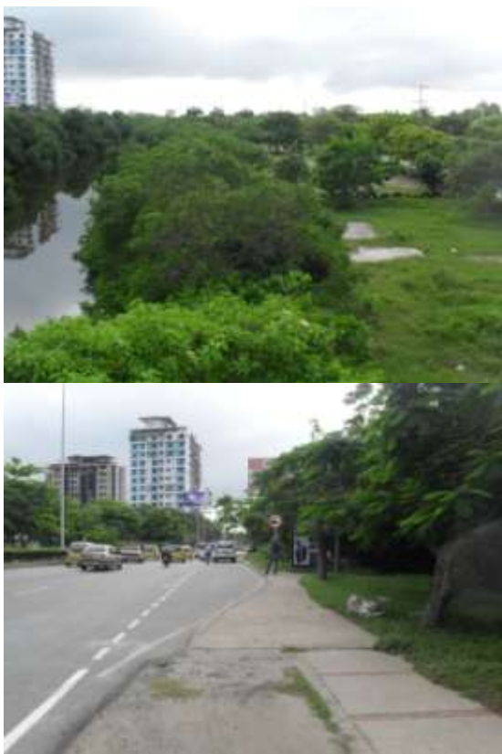
Foto No. 1 Sitio de inicio de la perforación Foto No. 2 Sitio de salida de la perforación
