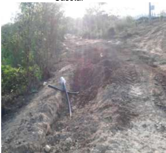
Tubería de distribución.
