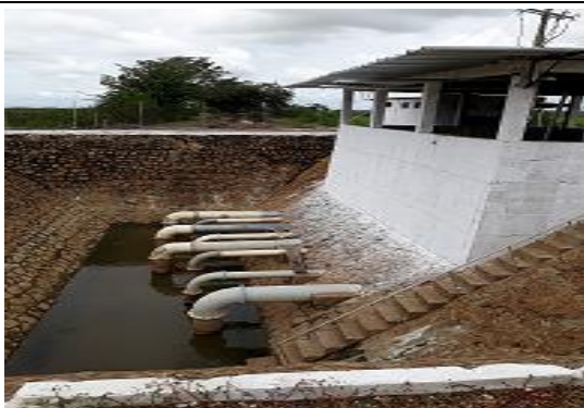
Foto 3. Sistema de Captación y bombeo
