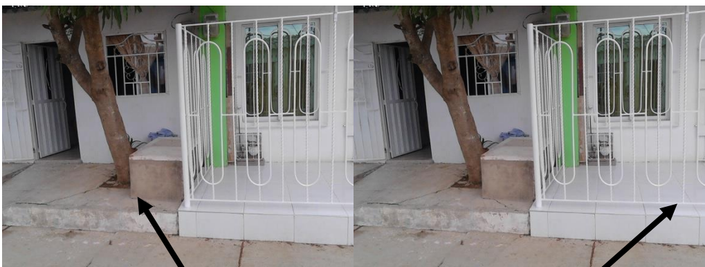
Piso con grietas donde está el árbol de Mango
