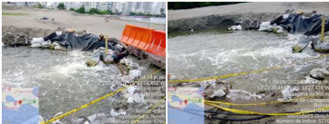
Ilustración 16. Evidencia fotográfica del funcionamiento de la bomba de intercambio entre el mar caribe y El laguito.
